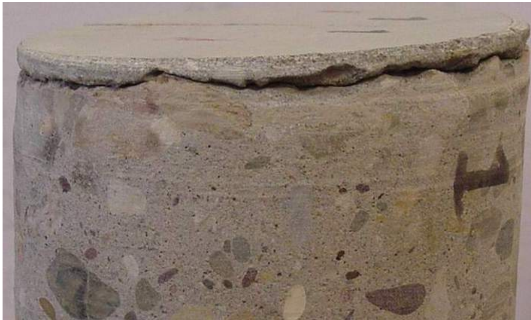
Bild 1.2: Hohlliegende Oberschicht eines monolithischen Betonbodens
