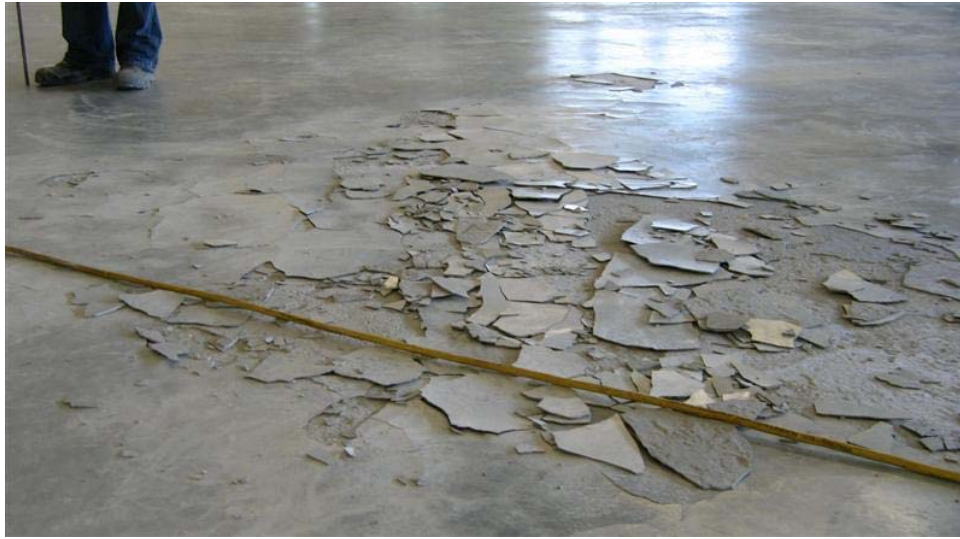
Bild 2.2: Hohlliegende Oberschicht bei einer verhältnismäßig großen Bodenoberfläche
